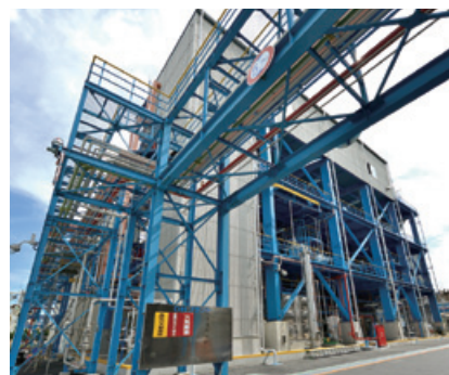
特殊架橋タイプ Zetpol®生産設備(川崎工場)
