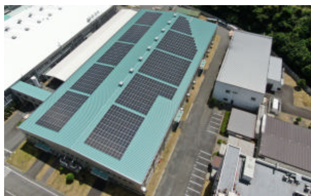
安富工場に設置した太陽光パネル
