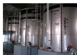
浄水場・次亜貯留タンク
