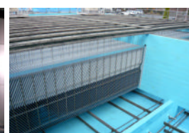
浄水場・沈殿傾斜板
