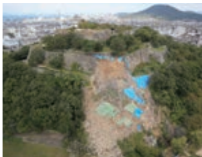
南西側石垣が崩落した丸亀城
