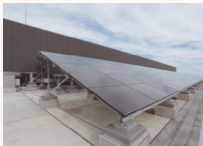
メンテナンスエリア (屋上:太陽光パネル)
