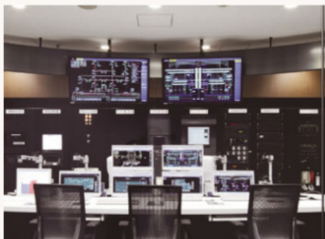
データセンターの中央監視室
