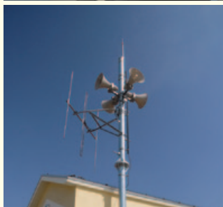
現在稼働中の防災行政無線システム
