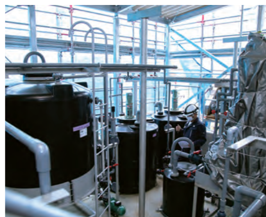
設置済みの設備（2023年5月時点）
