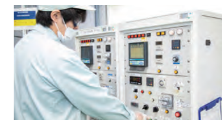
制御盤による作業自動化安全化・効率化を進めます。
