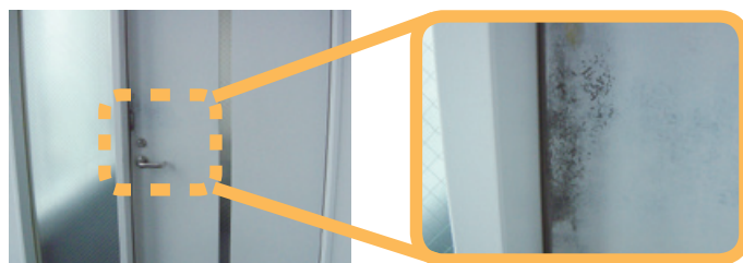
《皮脂軟化による塗膜剥離の事例》
