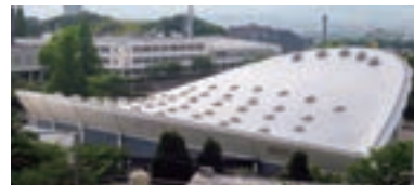
シート防水材用塗料「ノンリークコート」(パナソニックアリーナ(大阪))
