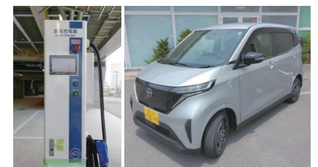
EV急速充電器
