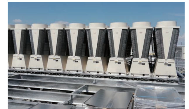
高効率熱源空調設備
