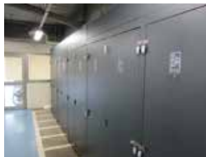
施設内に設置されたB-box
