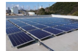
LCCOCの太陽光発電設備
