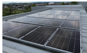
太陽光発電システム
