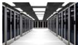
高速通信 （データセンター）
