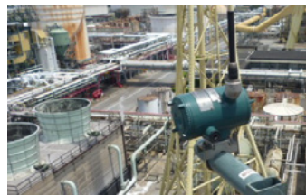
所内設備に取り付けられた無線センサー
