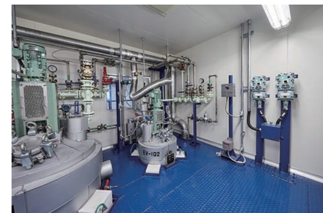
最先端レジスト用ポリマー製造設備 建屋内観
