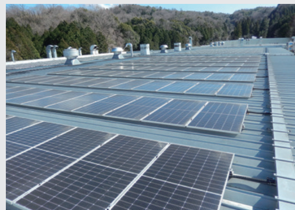
東海化成工業㈱に設置した太陽光パネル
