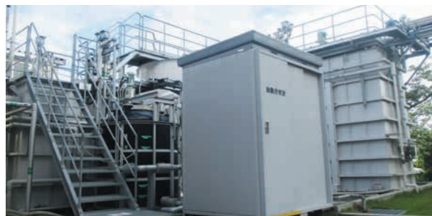
排水処理施設
