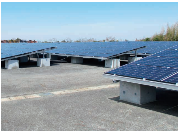
太陽光発電施設
