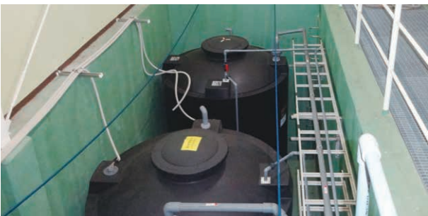
廃液回収循環施設
