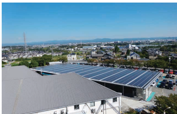
太陽光発電設備
