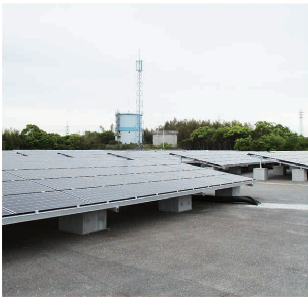
太陽光発電施設
