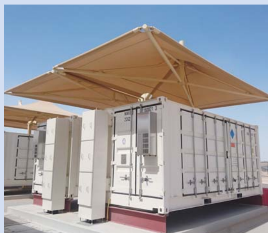
ドバイに設置されたNAS電池
