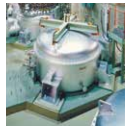
全国の原子力施設で採用され、廃棄物の低減に貢献している「低レベル放射性廃棄物処理装置」
