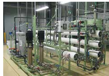
逆浸透膜を用いたろ過装置
