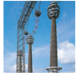
世界最大の磁器製品を用いた100万ボルト級 「変電用ガイシ・機器」
