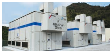
隠岐ハイブリッドプロジェクトに設置されているNAS ® 電池
