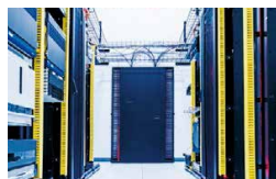
データセンター
