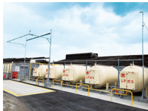
朝日珪酸工業(株)のLPG貯槽設備
