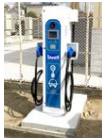
堺工場に設置された電気自動車の充電ステーション
