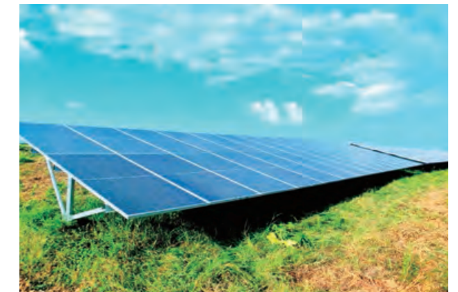
太陽光発電設備
