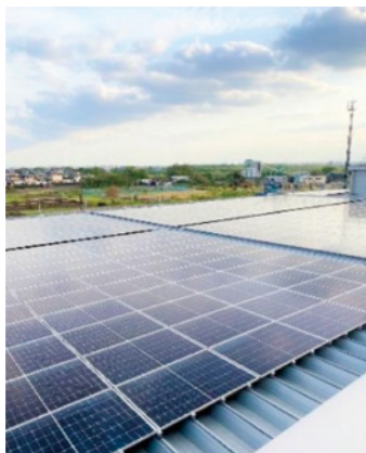
岐阜工場の屋根に設置した太陽光発電パネル (2023年稼働開始)
