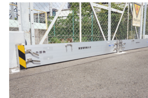
豪雨等による浸水被害対策として設置した止水板
