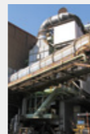
排熱回収設備
