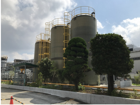
新設された設備外観
