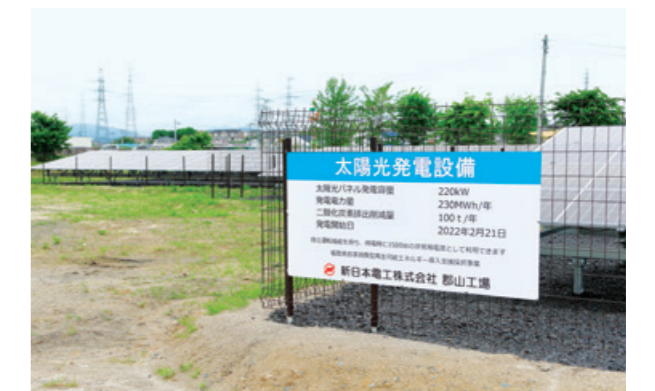
太陽光発電設備(郡山工場)
