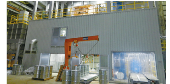
富山工場(射水地区) 酸化ほう素製造設備
