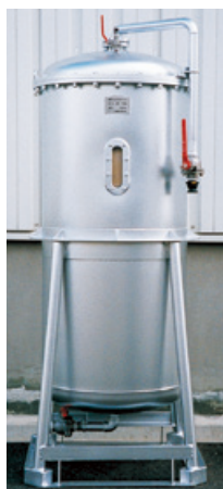
排水処理用イオン交換樹脂塔
