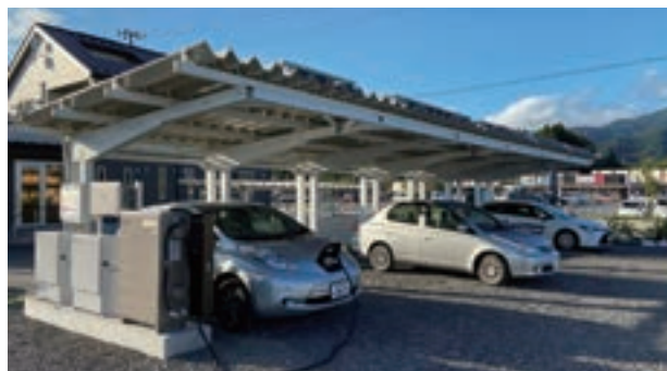
寄贈したEVソーラーカーポートシステム
