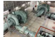
小又川新発電所 建屋内部(水車、発電機)
