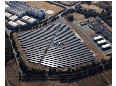
真壁太陽光発電所
