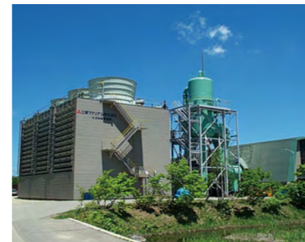
大沼地熱発電所
