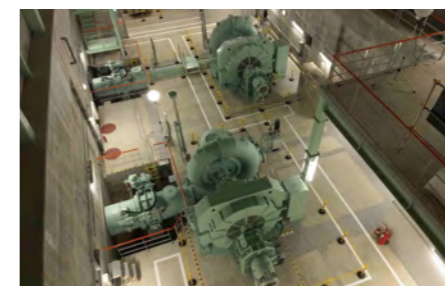
小又川新発電所 (水車発電機)
