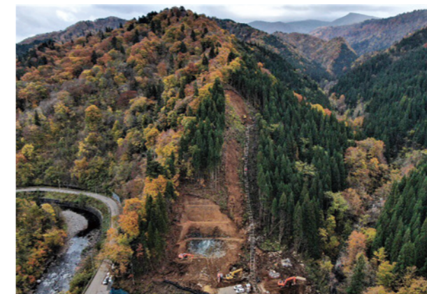
小又川新水力発電所(秋田県北秋田市) (建設中) 事業主体: 三菱マテリアル(株) 2022年12月運転開始予定(出力10,326kW)
