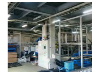
太陽光パネル処理 実証試験ライン
