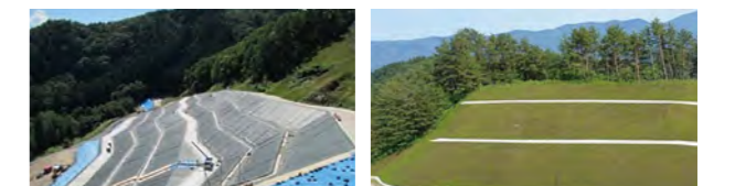
小真木鉱山 清濁分離工事 遮水シート部 小真木鉱山 清濁分離工事 チップクリート部
