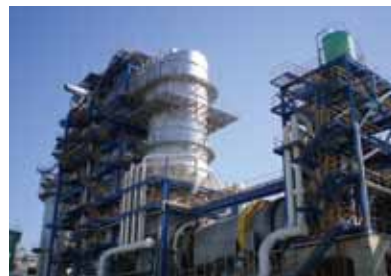
廃棄物焼却処理設備
