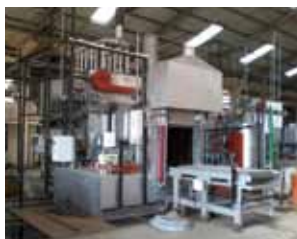
インドの熱処理加工設備
