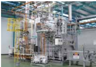
インドネシア工場の熱処理炉
