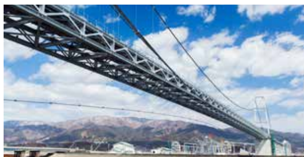
陸前高田市における高台移転工事向けに採用された長距離ベルトコンベヤ
