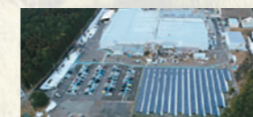
銅箔事業部門(栃木県日光市)に設置した太陽光発電パネル
