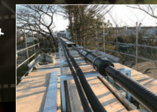
三相同軸超電導ケーブルシステム
