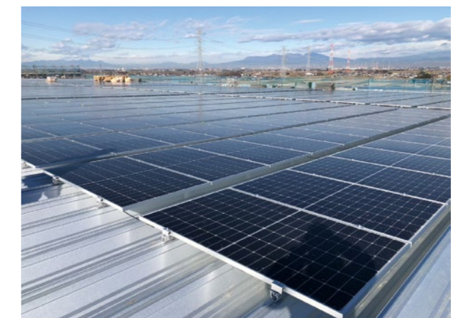
太陽光パネル
