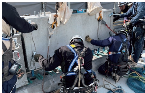
ラビッドガードフェンス（荒牧高架橋）
