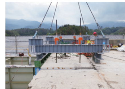
床版の損傷状況
