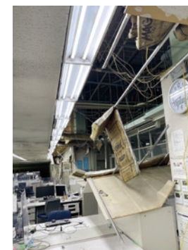
高岡工場 (天井材が落下した様子)
