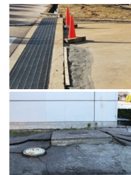
奈呉工場 (地面の隆起や液状化の様子)
