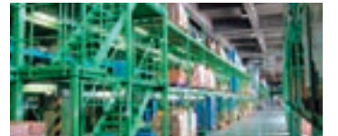
物流保管設備機器 (ラック)
