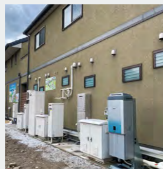
設置された水素100%燃焼給湯器
