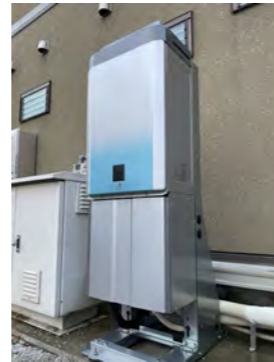
水素100%燃焼給湯器の実証実験 (北九州水素タウン)
