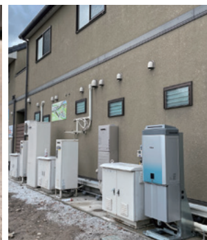
設置された 水素100%燃焼給湯器
